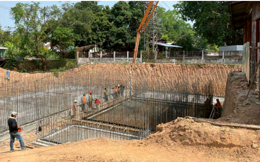
Laos: Es handelt sich um ein DEWATS für das Krankenhaus der Provinz Khammouane im Rahmen des Greater Mekong Subregion Project (GMS4), bei dem BORDA Laos technische Hilfe leistet. Das Foto wurde im März 2023 aufgenommen, und der Bau wird bis Ende dieses Jahres abgeschlossen sein.
