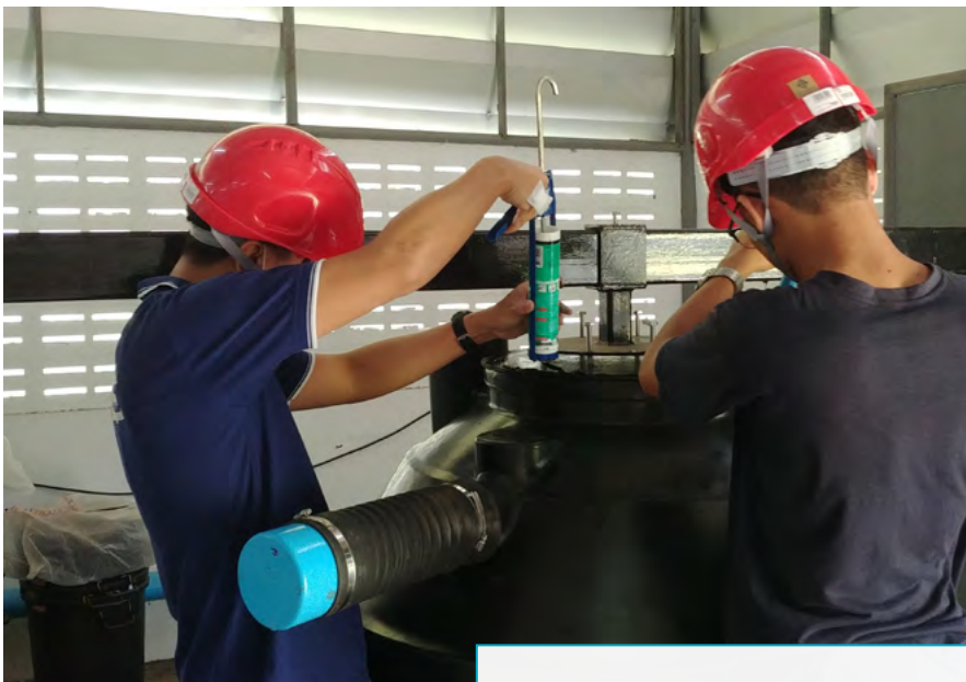
Thailand: Personalschulung zur Durchführung eines Vakuumtests
