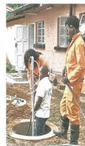
Sanitäranlage in Tansania.
