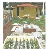
Dezentrale Kläranlage DEWATS in Mexiko.
