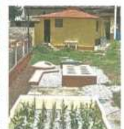
Dezentrale Kläranlage DEWATS in Mexiko.
